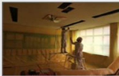
<건물 철거 석면 노출>
