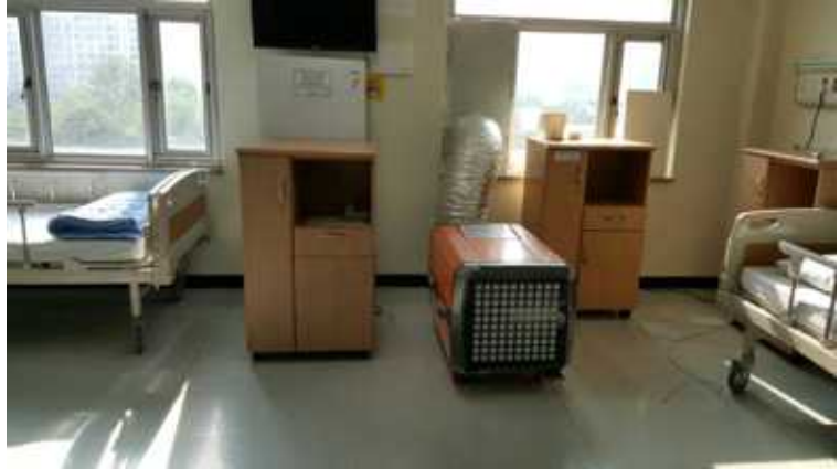
이동형 음압장비 설치
