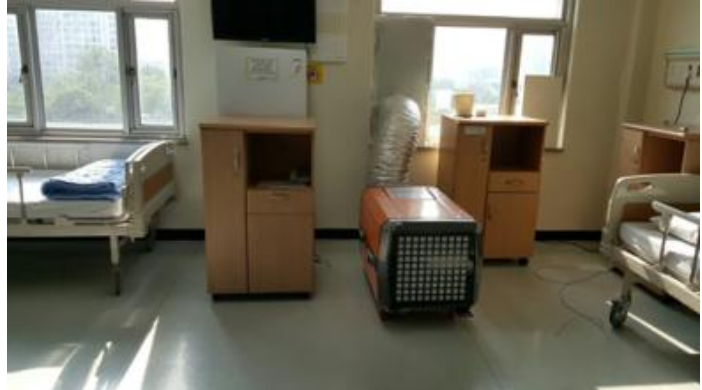
이동형 음압장비 설치
